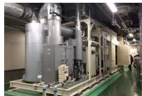
図 2-38 エネルギーセンター
