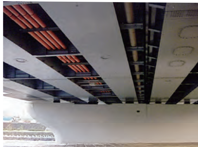
桁下デザインで配管をすっきりと納めている(〇〇〇〇〇〇〇〇〇〇〇〇)
