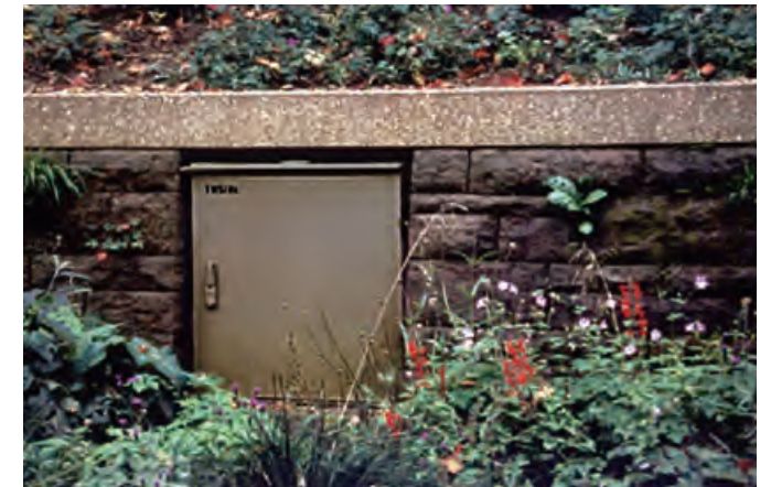
擁壁の中に設備を組み込み目立たなくする工夫(〇〇〇)
