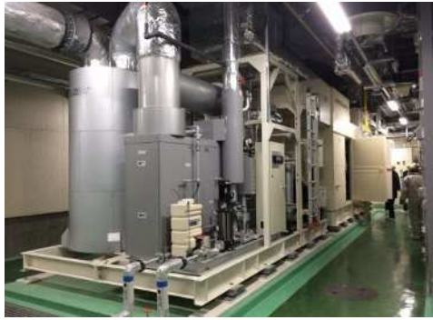
例：エネルギーセンター（創世エネルギーセンター）
