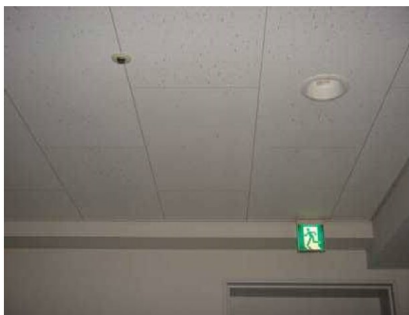
アスベスト含有石膏ボード(天井)
