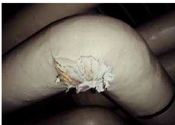
アスベスト含有配管保温材(配管)
