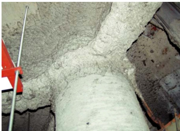
吹付けアスベスト(梁)
