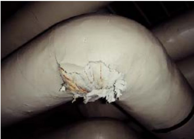
配管エルボ保温材
