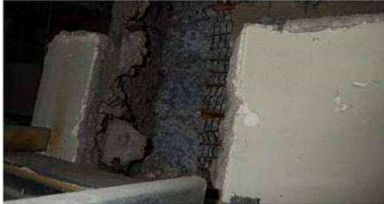
壁の中にクロシドライト（青石綿）が吹き付けられていた例（国マニュアルより）
