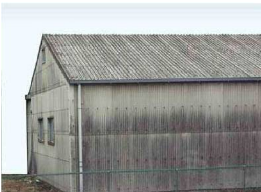
アスベスト含有スレート波板（屋根）
