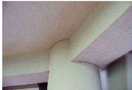
アスベスト含有吹付けパーライト (天井)
