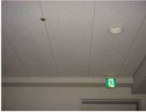
アスベスト含有石膏ボード（天井）
