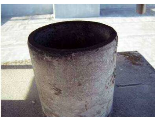
アスベスト含有煙突用断熱材 (煙突)
