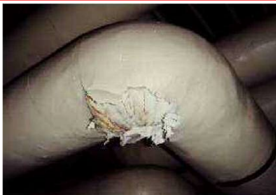
アスベスト含有配管保温材 (配管)
