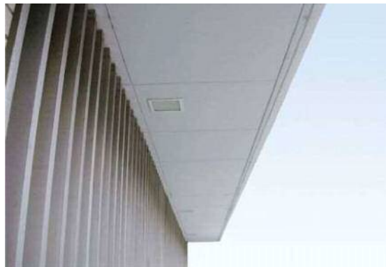
アスベスト含有けい酸カルシウム板第1種（軒天）
