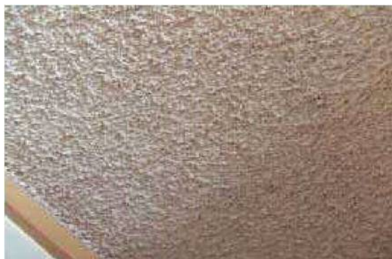
アスベスト含有吹付けパーミキュライト (天井)
