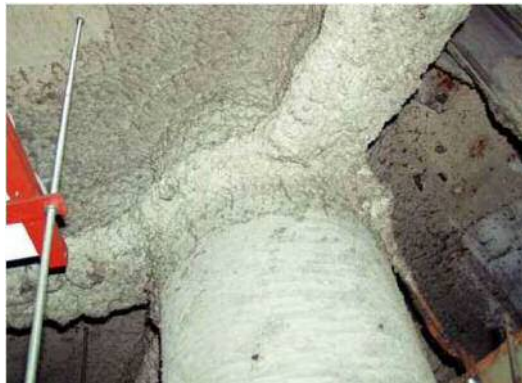
吹付けアスベスト (梁)
