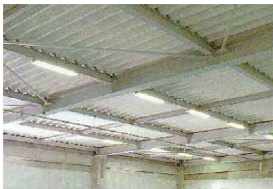
アスベスト含有屋根用折板断熱材 (天井)
