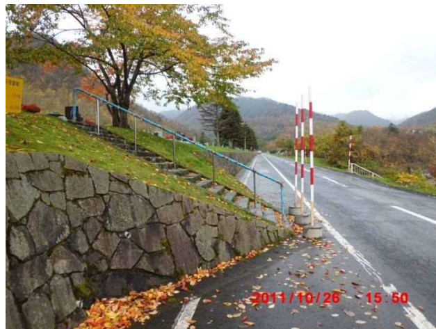
B-2号の突出している階段（図面番号①）
