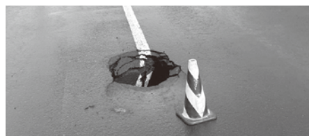
本年2月、清田区で発生した道路陥没発見状況
