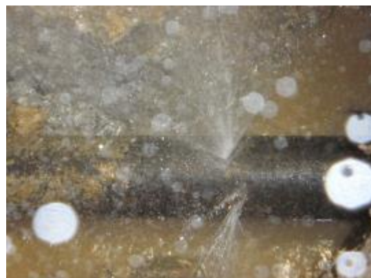
配水管からの漏水
