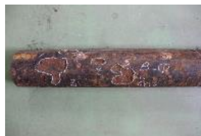
腐食が進んだ配水管（約 50 年経過）
