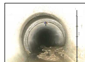
管路のつなぎ目のずれ
