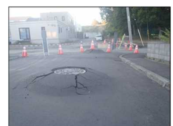
マンホールの浮上
