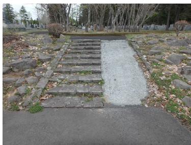
手すりのない階段
