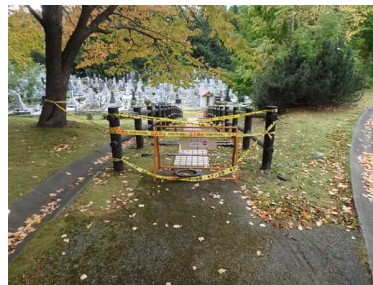
老朽化した階段
