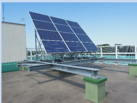
太陽光発電設備
