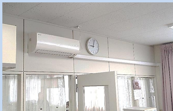
冷房設備（壁掛けエアコン）
