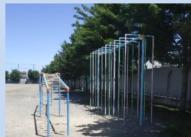
塗装が剥離し老朽化した遊具
