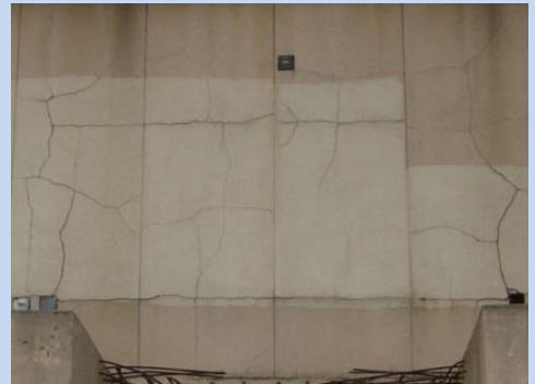
外壁のひび割れ、剥離
