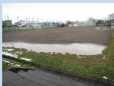
大きな水溜まりが発生
