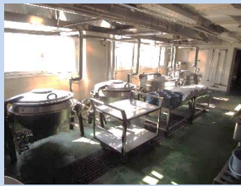
老朽化した給食調理室
