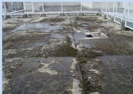
屋上保護コンクリートの劣化
