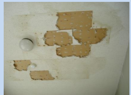
漏水による天井材の劣化
