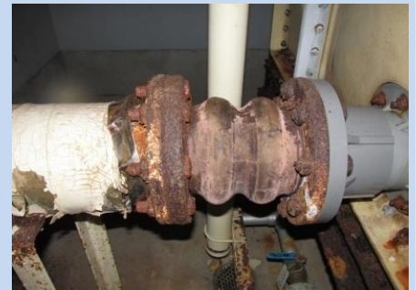
給水設備の老朽化
