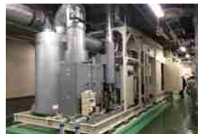
図 2-38 エネルギーセンター
