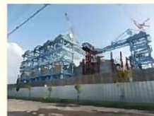
雨水ポンプ場
