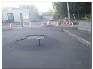
マンホールの浮上 (北海道胆振東部地震(2018年))
