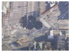
埼玉県の道路陥没事故の状況 (出典:国土交通省)
