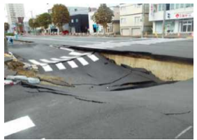
北海道胆振東部地震による道路陥没(出典:札幌市)
