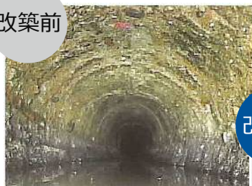
内面が腐食した管路
