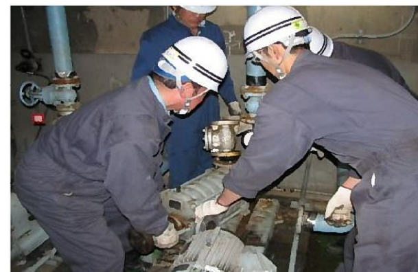
【処理施設の保守点検】
