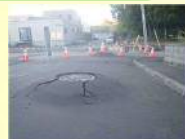
液状化の状況 【脆弱状況を踏まえた耐震化】
