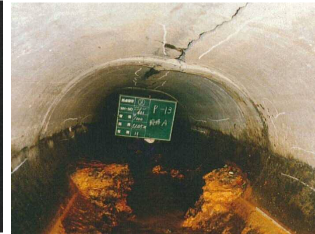
② 上部に亀裂の入った管路
