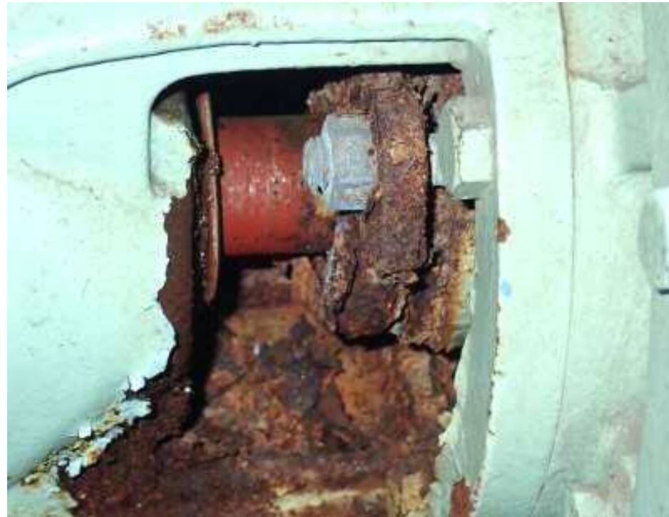
腐食したポンプ設備
