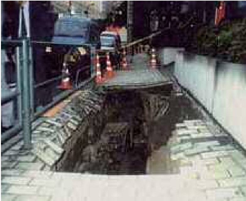
大規模な道路陥没（他都市）
