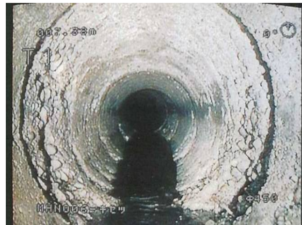
① 表面が劣化した管路
