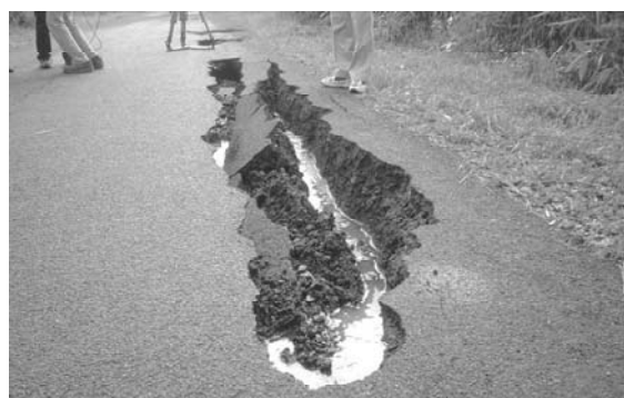
平成15年十勝沖地震 札幌市東区中沼町 （下水道本管上の道路陥没）
