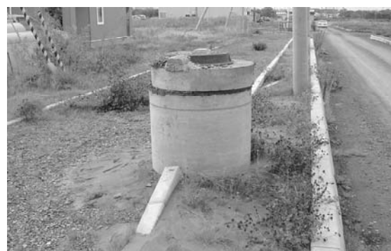
平成15年十勝沖地震 釧路町別保原野新東陽団地 （地盤の液状化によるマンホールの浮上） 写真提供：首都大学東京 土質研究室
