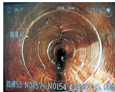
下水道施設の老朽化の進行
