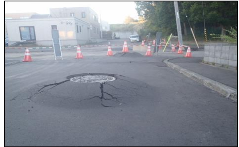
マンホールの浮上
