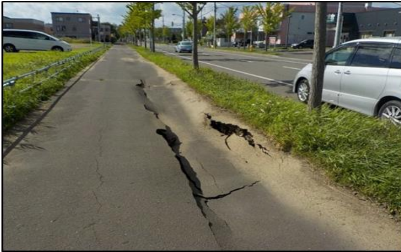
管路上部の地盤沈下
