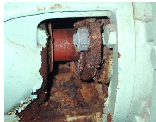
腐食したポンプ設備
