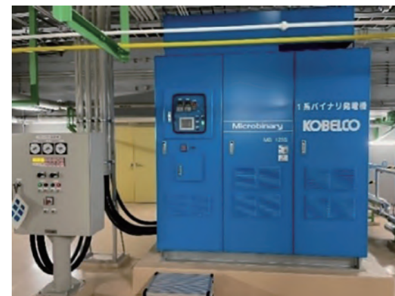
廃熱発電設備の設置状況
