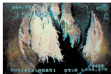
木の根の侵入
