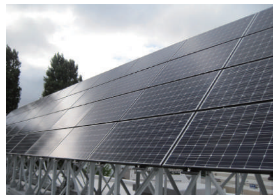
東部下水管理センター 屋根置き太陽光
