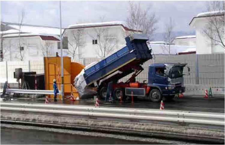
八軒下水道管投雪施設
