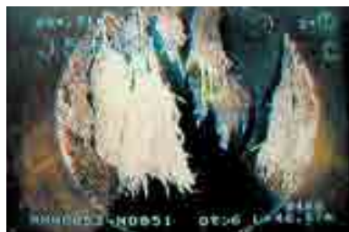
木の根の侵入
