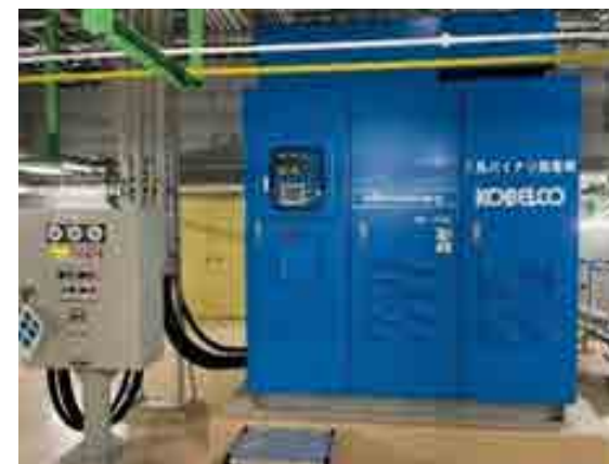
廃熱発電設備の設置状況
