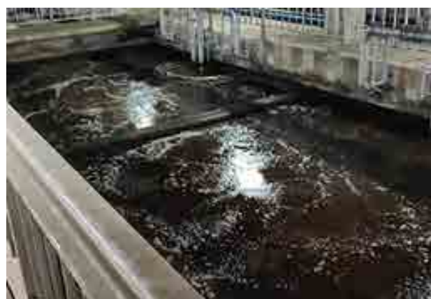
超微細気泡散気装置の稼働状況
