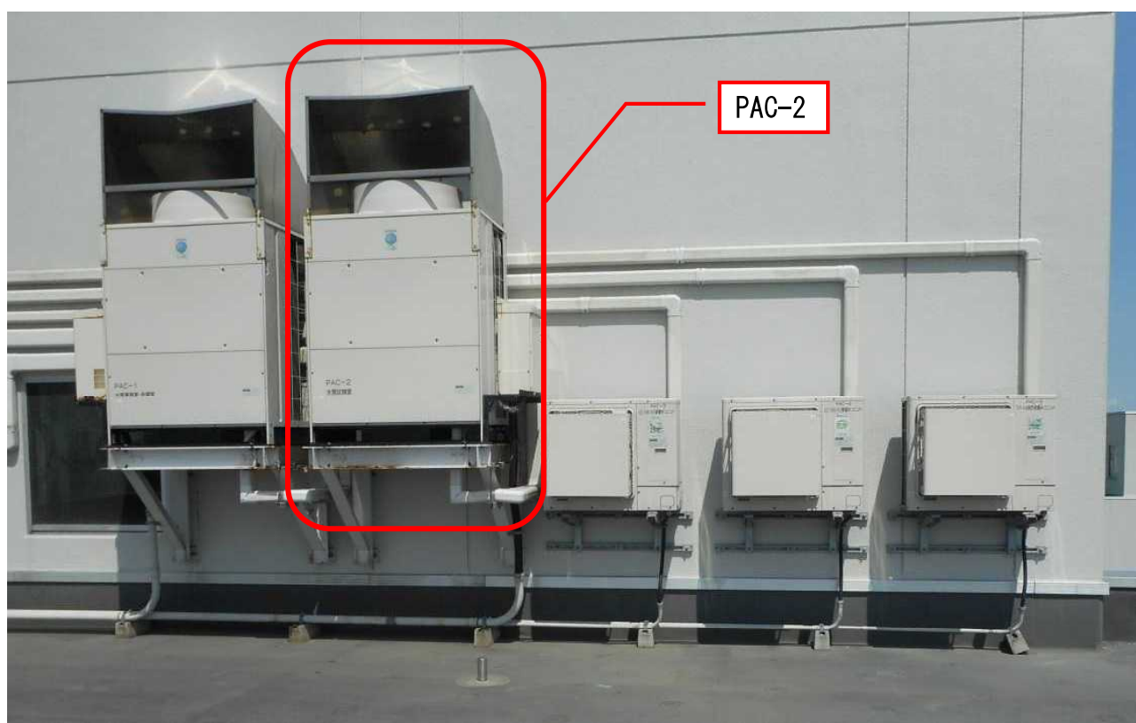
図 1：水質管理棟パッケージエアコン室外機（屋上）
