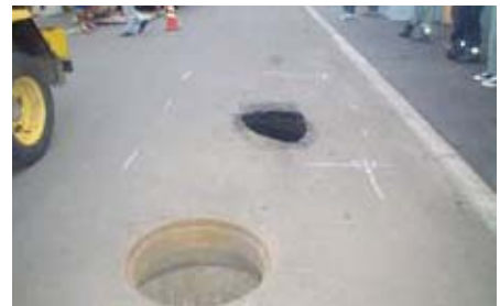
■ 管路の損傷による道路陥没
