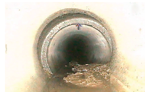
管路のつなぎ目のずれ
