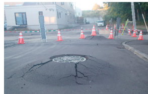
マンホールの浮上
