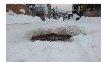
積雪時における下水道マンホールによる段差状況
