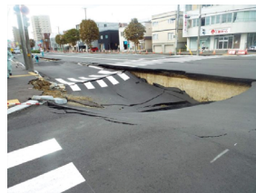
北海道胆振東部地震による道路陥没（出典：札幌市）
