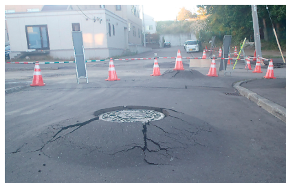
マンホールの浮上 (北海道胆振東部地震(2018年))
