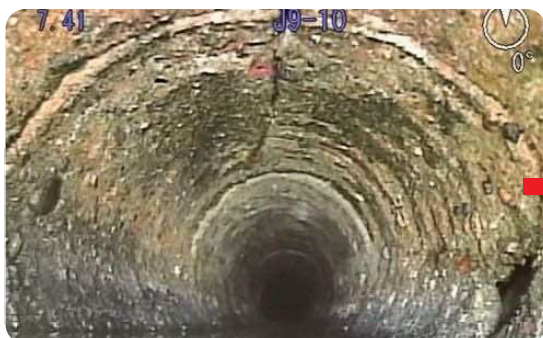
古い管の様子
