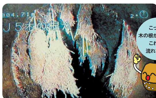
木の根の侵入
