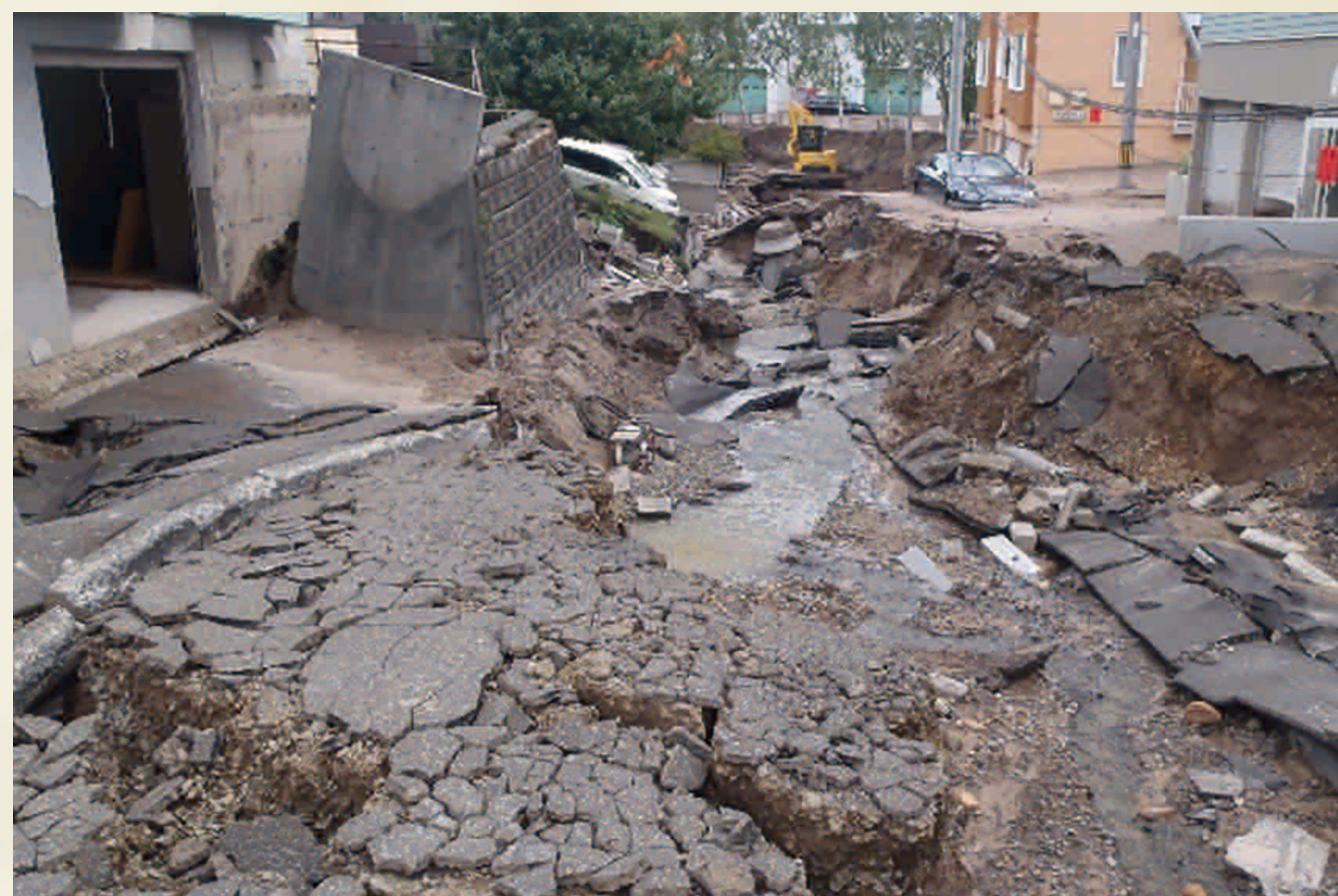
北海道胆振東部地震での被災状況(2018年) 液状化によるマンホール浮上等の管路被害
