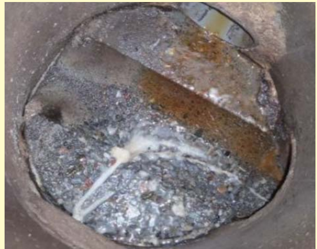
左手前が腐食した公共ます
