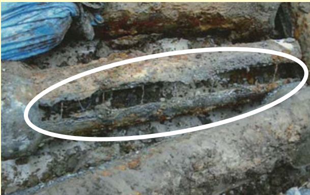
底が損傷した下水道管
