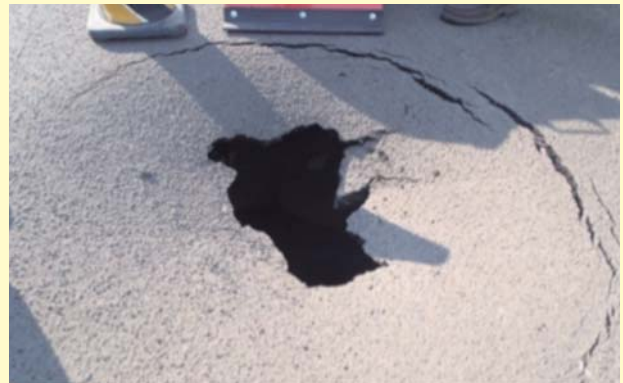
下水道管の損傷による道路陥没
