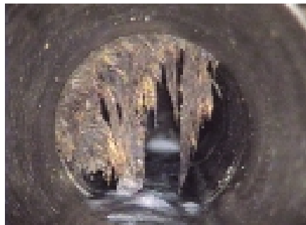
点検により確認された木根貫入箇所
