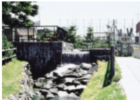
高度処理水の安春川への吐口
