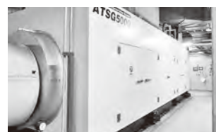
天然ガスコージェネレーション (札幌駅南口 EC、容量 8,670kW)
