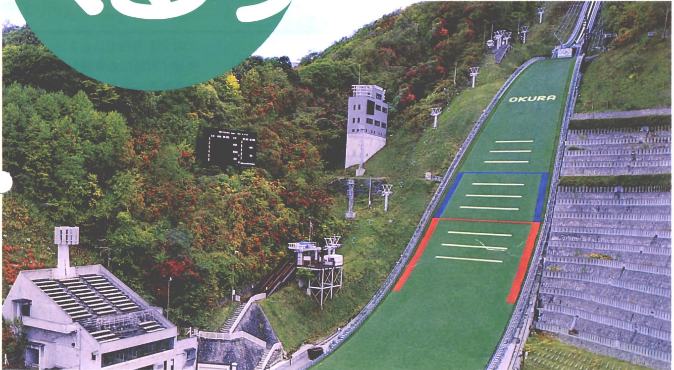
夏も競技でき、ナイターも楽しめる照明設備を整備中。12月には完成予定。 (大倉山ジャンプ競技場)
