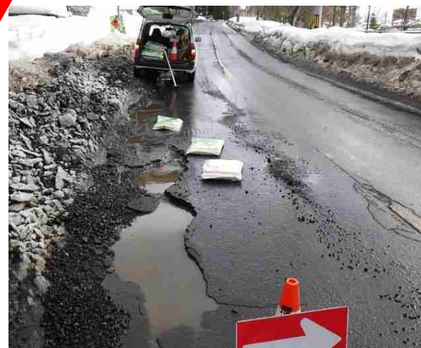
凍結融解による舗装損傷状況
