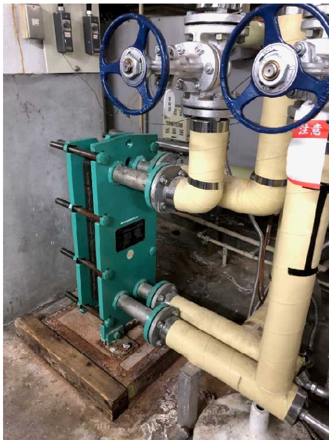
対象写真（熱交換器本体）
