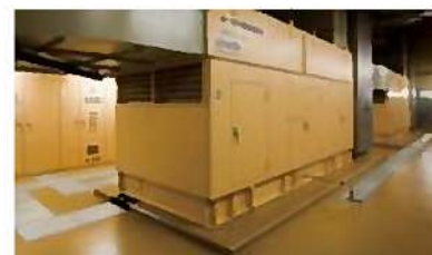
非常用発電機 出典) 三宮事業計画
