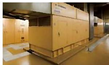
非常用発電機 出典)三宮事業計画
