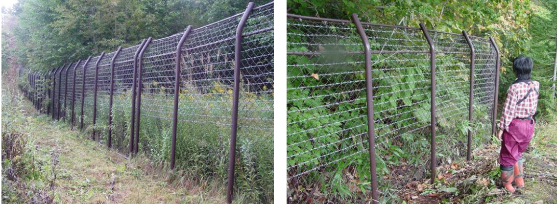
写真 3-10-1 滝野すずらん公園のヒグマ侵入防止柵 ※高さ約 2.5m の金網フェンス。上部が忍び返しの形状になっている。 また、中段から上にはバラ線が付加されている。
