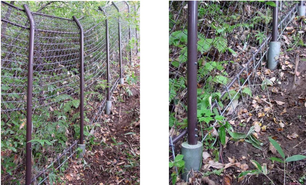
写真 3-10-2 ヒグマの侵入を防ぐために補強された柵
