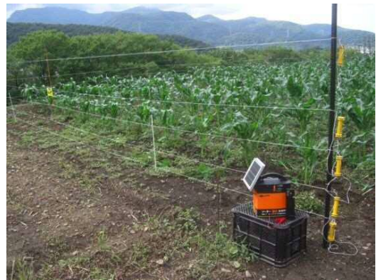
電気柵設置例
