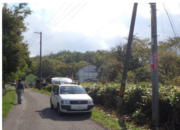
写真4 注意喚起看板 遠景
