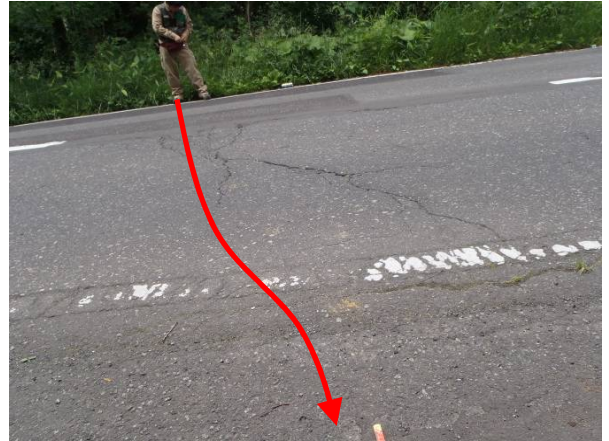
写真2 道路を横断した跡
