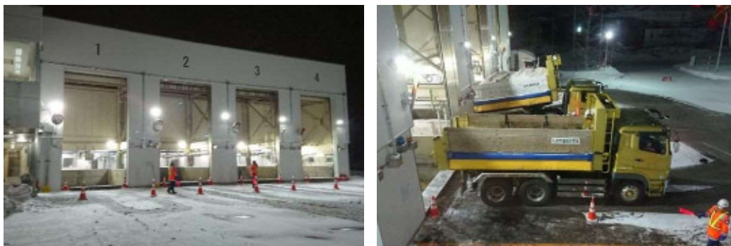
【図6-34 新川融雪槽における投雪状況】
