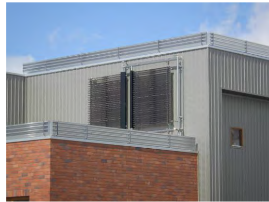
南面外壁に垂直設置した太陽集熱器
