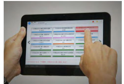
中央監視装置（データロガー） ジョンソンコントロールズ社製
