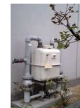
③ガス変換機接続口
