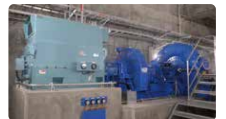
平岸配水池の水力発電設備
